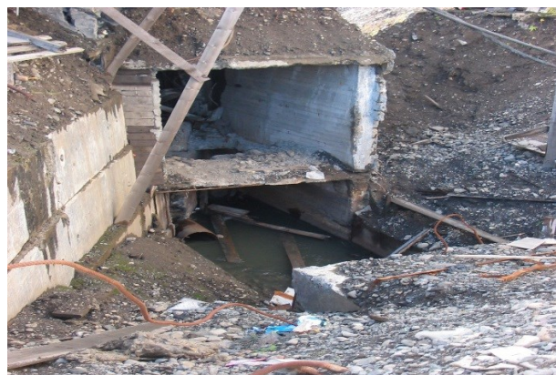
Рис. 4. Затопление нижнего яруса коллектора грунтовыми водами
