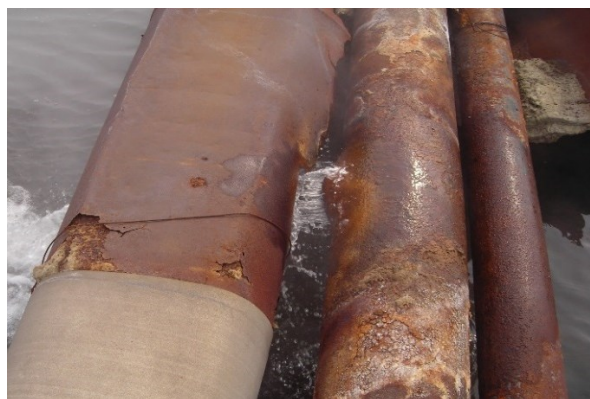
Рис. 3. Фильтрация стоков в водоем из-за коррозионного износа и повреждения трубопровода
