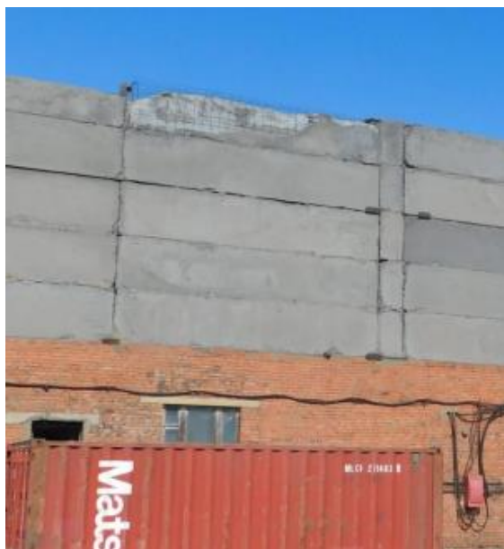
Рис. 5. Сквозная деструкция бетона стеновой панели
