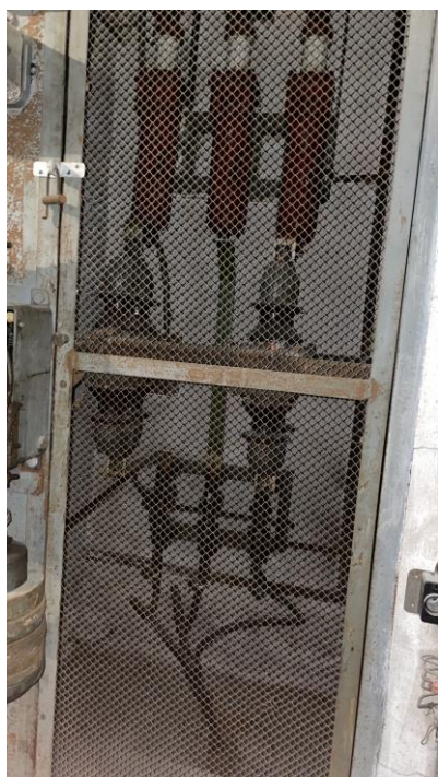
Рис. 5. Оборудование, требующее профилактического обслуживания. Выключатель масляный ВМГ-133 1962 г. выпуска
