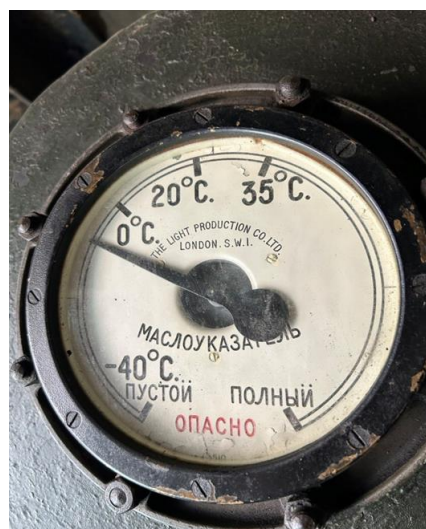
Рис. 2. Маслоуказатель трансформатора ТМ-1000/6
