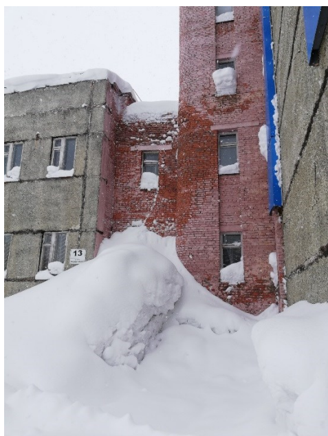
Рис. 1. Снежные завалы около аварийного здания с вентилируемым подпольем, Норильск, р-он Талнах
