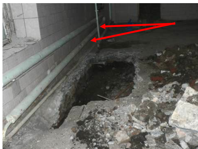
Рис 14. Дефекты водосброса второго этажа здания
