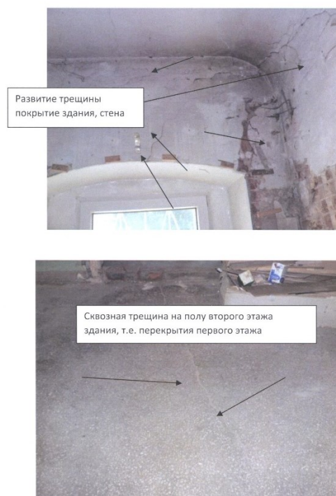
Рис. 13. Дефекты конструкций второго этажа здания
