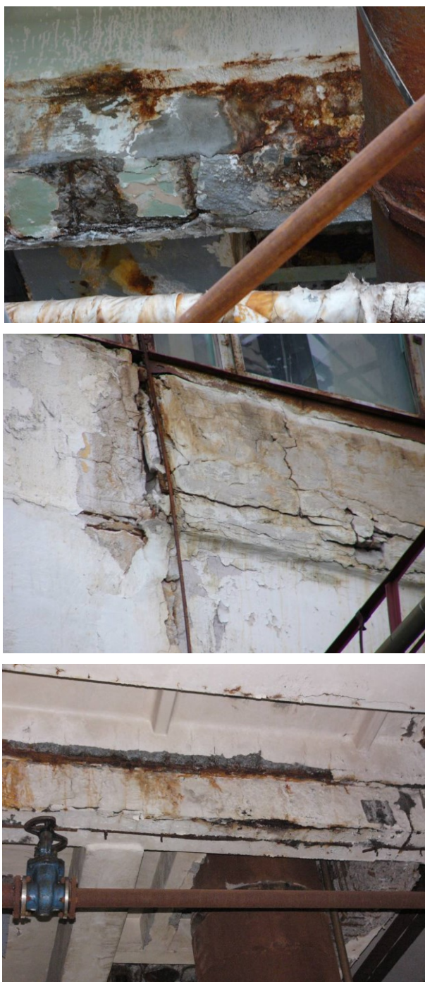
Рис. 16. Дефекты в корпусе 220 ФКП «Анозит»
